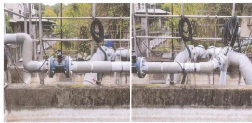
圖一、現場受測流量計安裝現況
